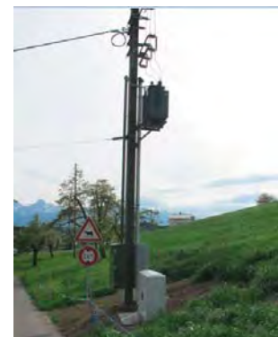
LV-LVR-Installation neben dem Masttransformator
