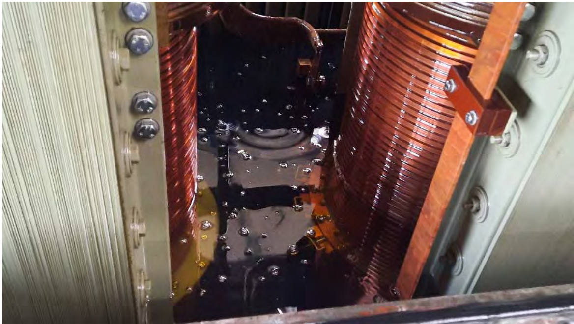
Bild 4: Blick in das Innere nach Inbetriebnahme des Filtersystems ES 2000. Die Vorzüge bei der Inspektion des Systems sind klar ersichtlich. Die Schleifringe des Schalters sind, auch im Öl eingetaucht, sehr gut sichtbar. Aufwändiges Spülen und mechanisches Reinigen entfällt.
